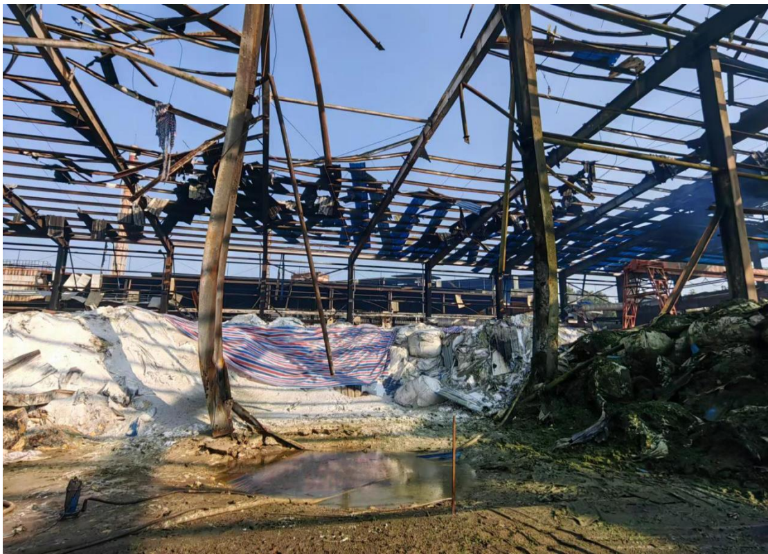
爆炸点形成的爆炸坑，梁、柱破坏情况
