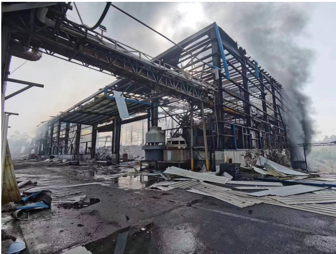
爆炸起火的七水硫酸锌车间建筑现状图
